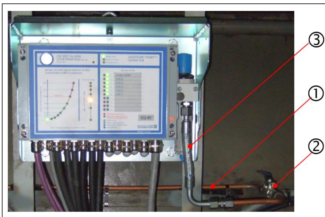
Fig. : 14 : Exemple d'une alimentation optimale en air comprimé vers l'unité centrale VN301 plus
